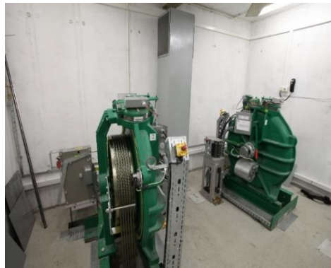
Rys. 6. Napędy dźwigów usytuowane w maszynowni
