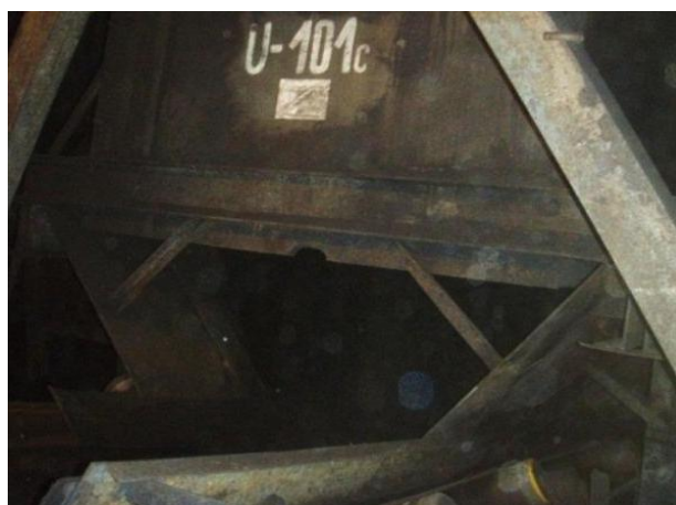
Rys. 2. Obudowany przesyp przenośnika stalowo-członowego nr U-101C [7]
