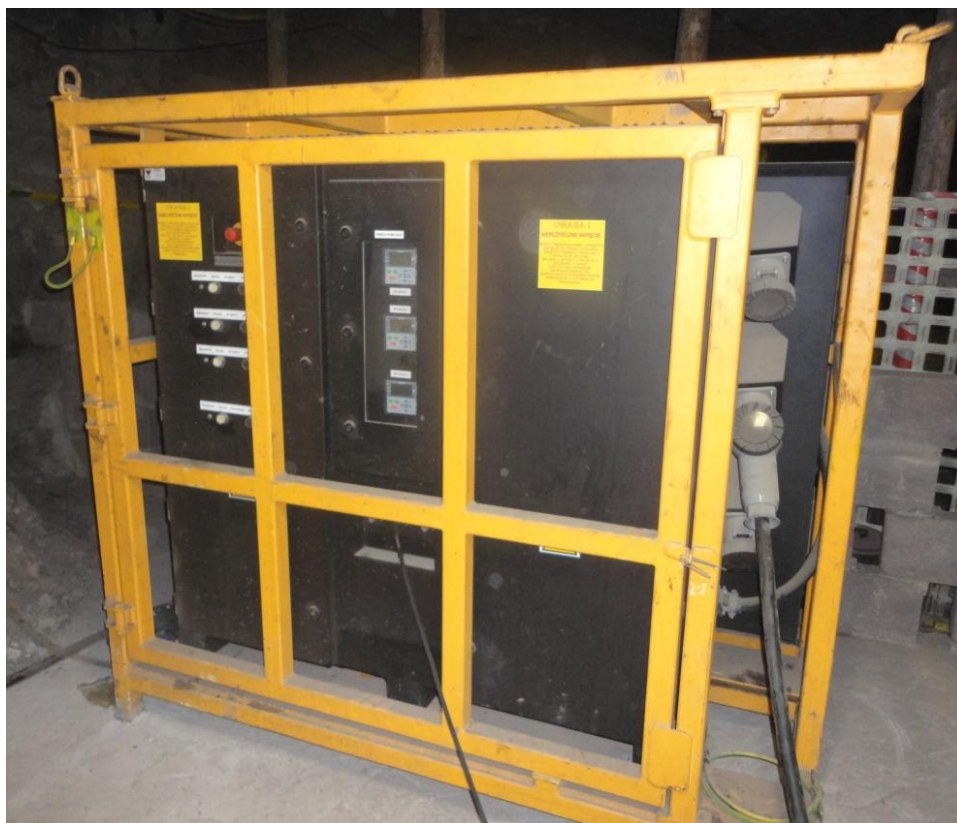
Rys. 4. Moduł ładowania zainstalowany w podziemiach kopalni [2]
