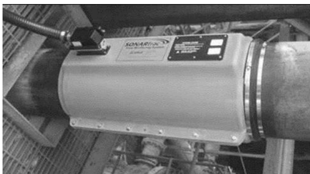
Rys.10. SONARtrac® zamontowany na instalacji
