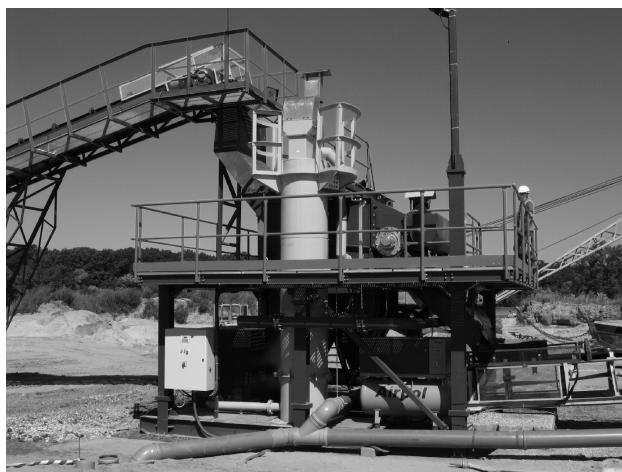
Rys.3. Widok osadzarki K-100 w Żwirowni w Januszkowicach
