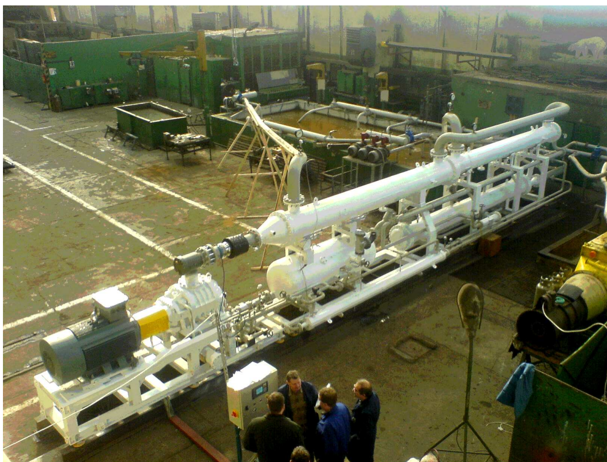
Rys.3. Agregat chłodniczy GMC-1000 w trakcie prób stanowiskowych
