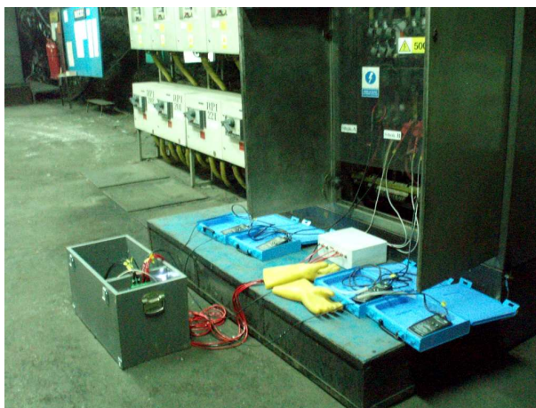
Rys.10. Stanowisko R3 do pomiaru parametrów elektrycznych [5]
