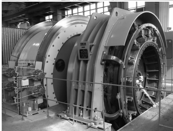
Rys. 2. Maszyna wyciągowa 4L-4000/3900 [źródło: własne]
