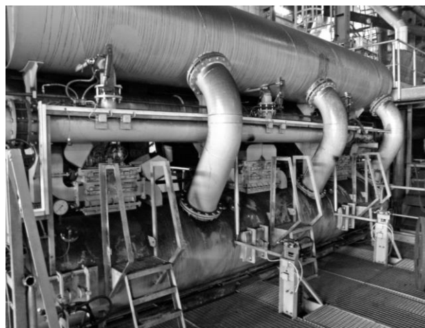
Rys.10. Osadzarka OM30 zabudowana w KWK Szczygłowice [25]
