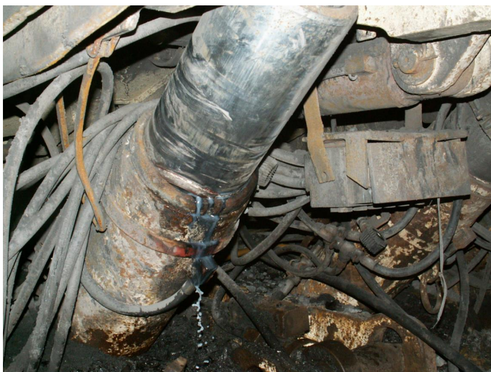
Rys.4. Wyrwanie dławicy z cylindra z przemieszczeniem wzdłuż osi stojaka [9]
