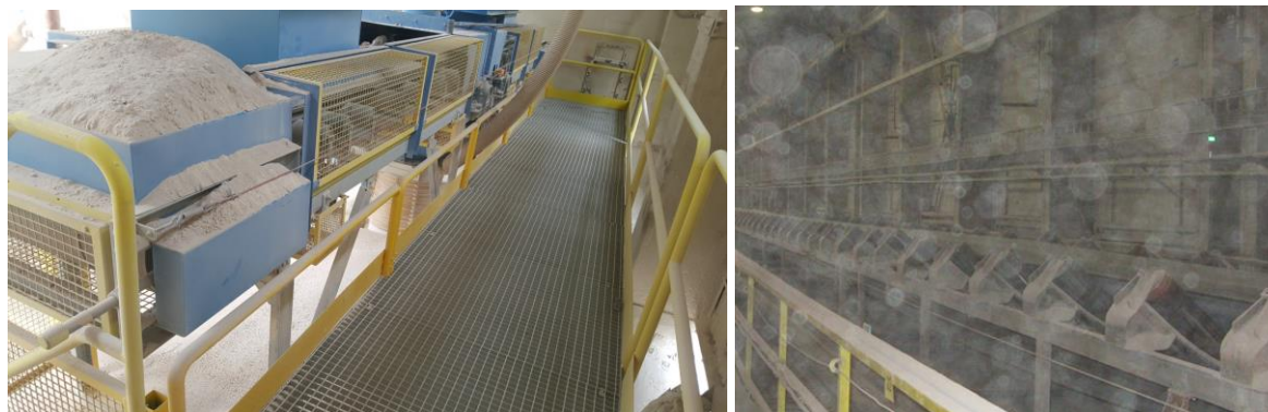
Rys. 1. Widoczne zapylenie przy przesypie oraz wzdłuż galerii przenośników stacjonarnych [6]
