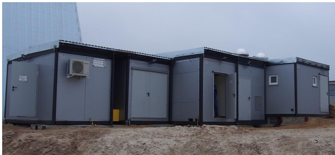
Rys. 2. Zabudowa kontenerowa maszyny wyciągowej MPPP-21
