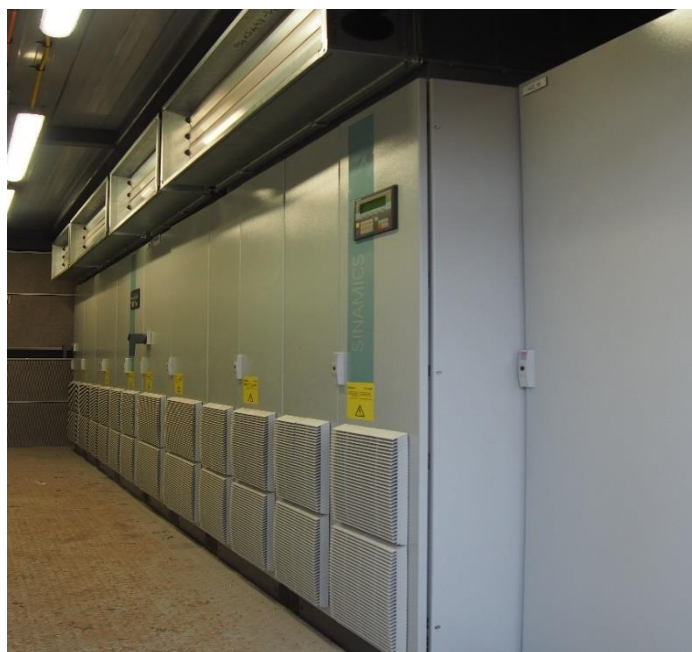
Rys. 3. Przekształtnik częstotliwości z układem czepni i wyrzutni wentylacyjnych
