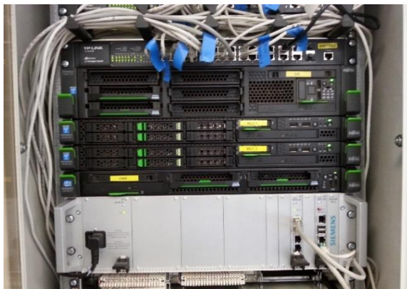
Fot.3. Serwery systemu HiPath Trading w szafie SWD (źródło: materiały własne)
