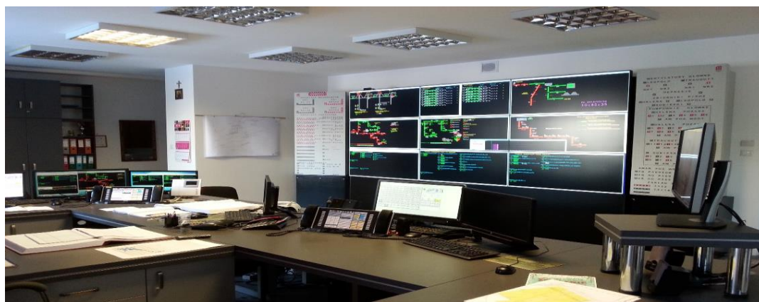
Fot.2. Widok pomieszczenia dyspozytorni zakładowej (źródło: materiały własne)
