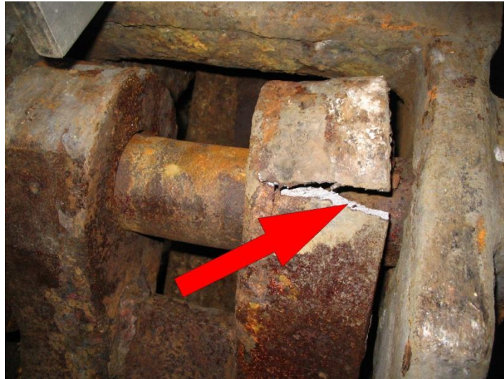
Rys. 6.19. Pęknięte ucho połączenia przegubowego [105]
