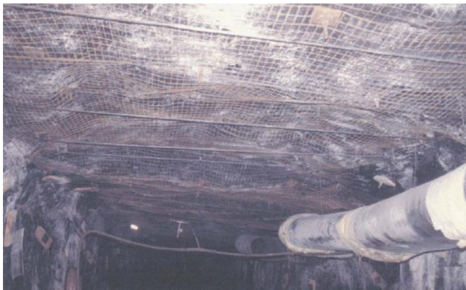
Fot. 3.4. Obudowa kotwowo-ciężnowa z linami stalowymi w wyrobisku korytarzowym [104]
