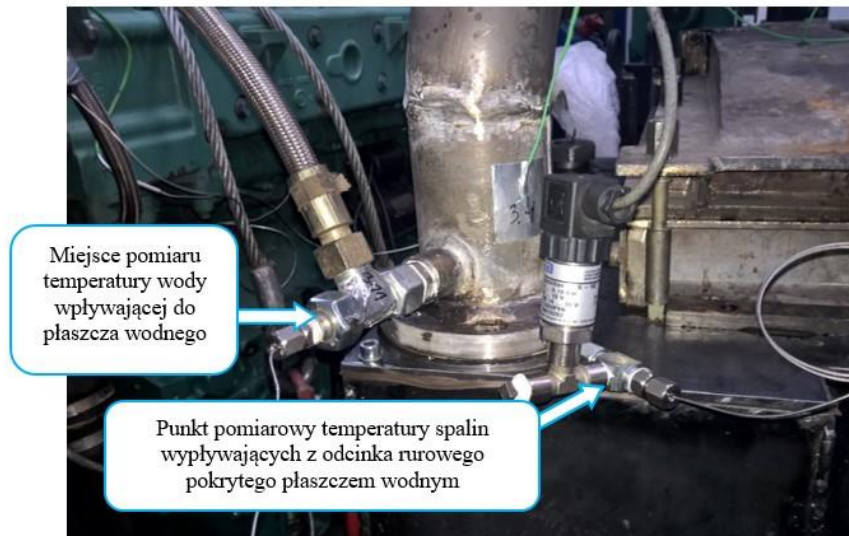
Rys. 21. Układ wylotowy - połączenie rury w płaszczu wodnym z wymiennikiem ciepła [45]
